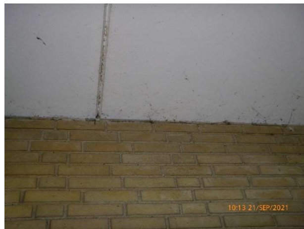
Foto 10. Revne langs gavlmur ved undersiden af dæk over 2. sal. (Punkt 8)
