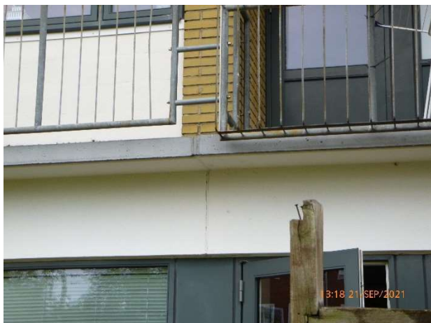
Foto 11. Der er generelt lodrette revner omkring fugerne mellem alle altanelementerne. Nogle steder er det dækkende betonlag på armeringen sprunget fra. (Punkt 9)
