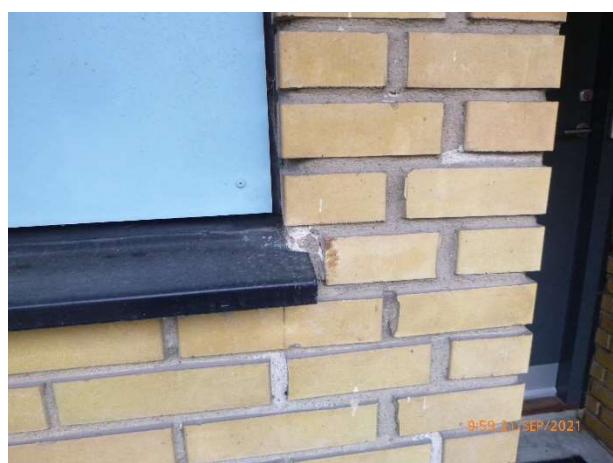
Foto 4. Ved enden af sølbænkene er mørtelfugerne knuste. (Punkt 4)
