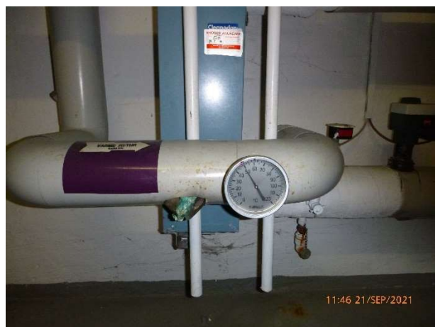
Foto 21. Overtryksventiler er ikke ført til gulv afløb. (Punkt 19)
