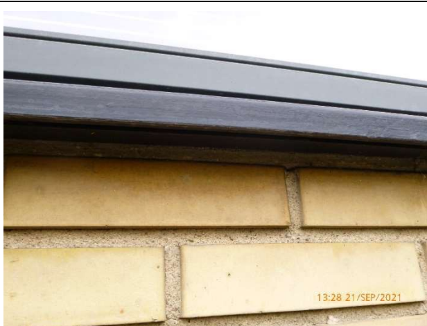
Foto 13. Der er generelt vandret revner under alle vinduers sålbænke. (Punkt 10)
