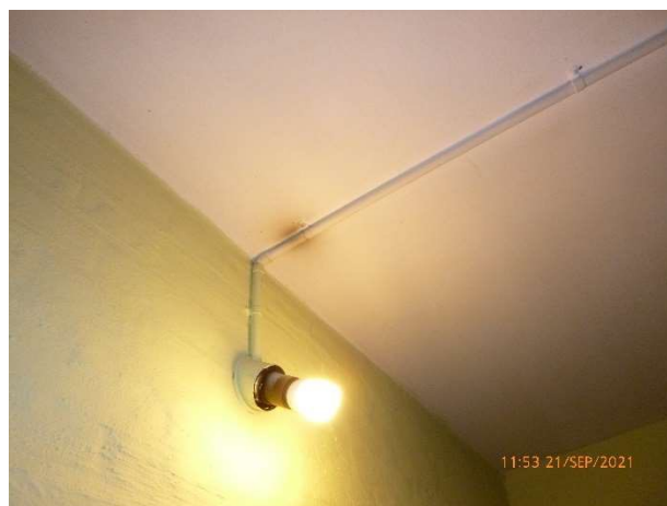
Foto 23. Der er en mørk skjold ved elinstallationen i loftet.
