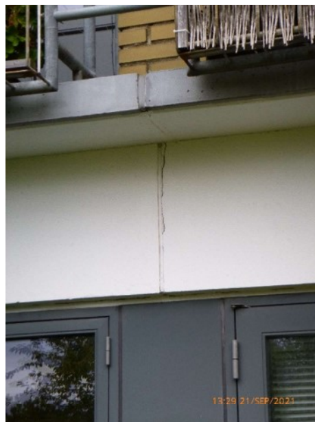
Foto 12. Der er generelt lodrette revner omkring fugerne mellem alle altanelementerne. Nogle steder er det dækkende betonlag på armeringen sprunget fra. (Punkt 9)
