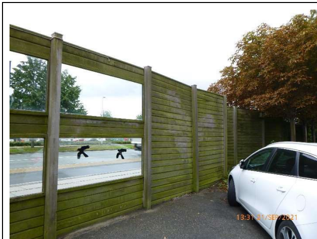
Foto 30. Der er lidt algevækst på bagsiden (Punkt 30)
