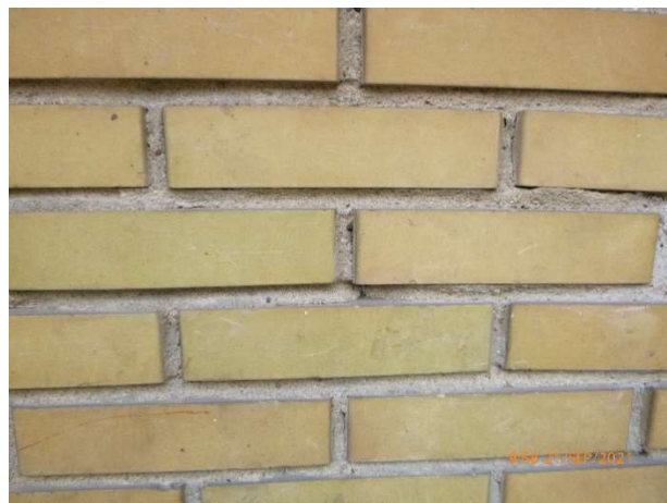
Foto 2. Hele gavlen: Der er mange studsfuger (de lodrette fuger mellem murstenene), som ikke er fyldte. (Punkt 2)
