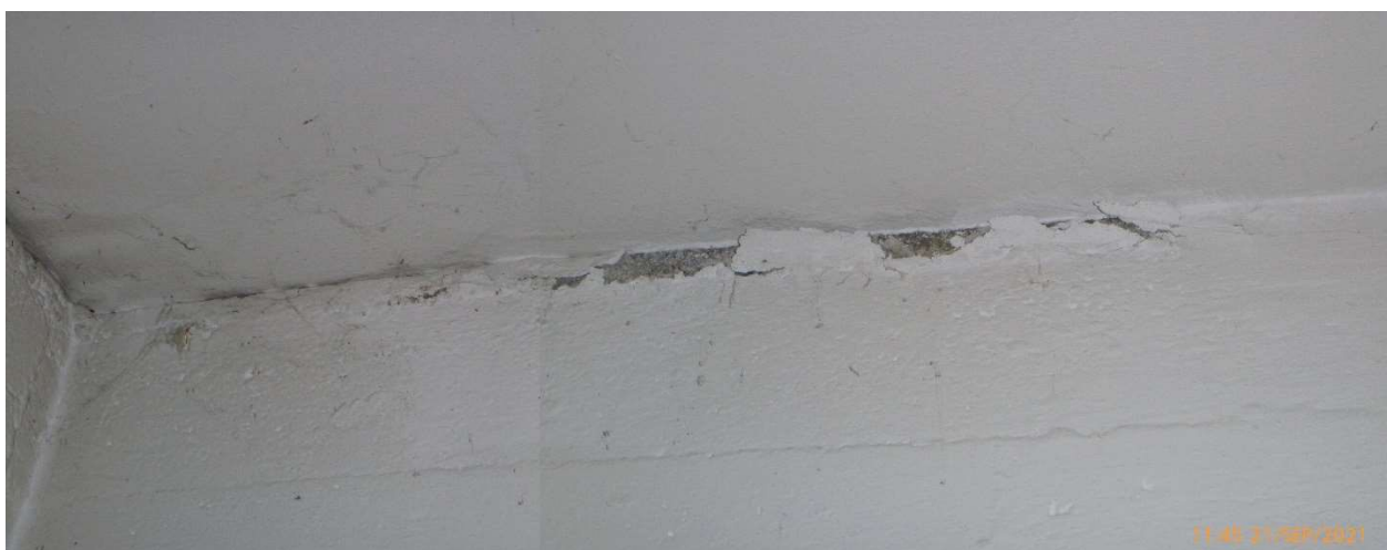
Foto 19. Der er en skade lige under loftet. Der er en afskalning eller knusning af toppen af væggen. Der kunne også være tegn på fugt. (Punkt 18)
