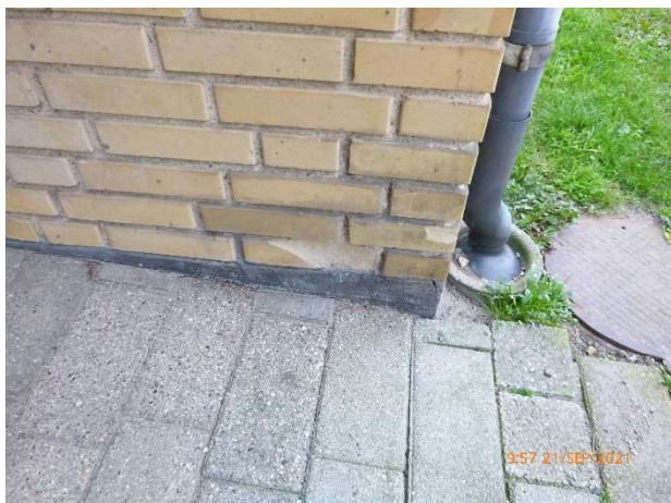
Foto 1. Afskalning af murværk lige over sokkel. (Punkt 1)
