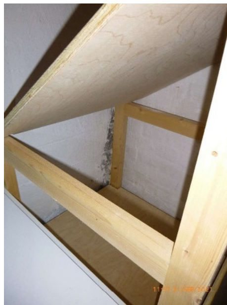
Foto 27. Fugt på ydervæg i lagerrum 63. (Punkt 23)
