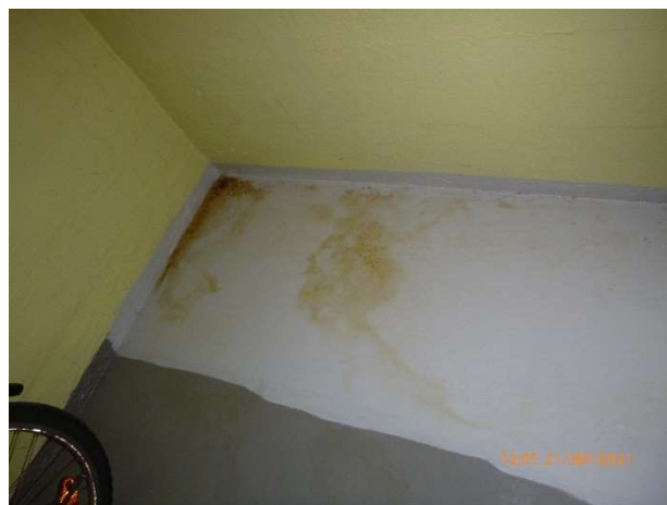
Foto 25. Der er skjolder på gulvet med aftegninger af rust. (Punkt 26)
