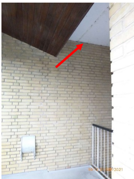
Foto 9. Revne langs gavlmur ved undersiden af dæk over 2. sal. (Punkt 8)
