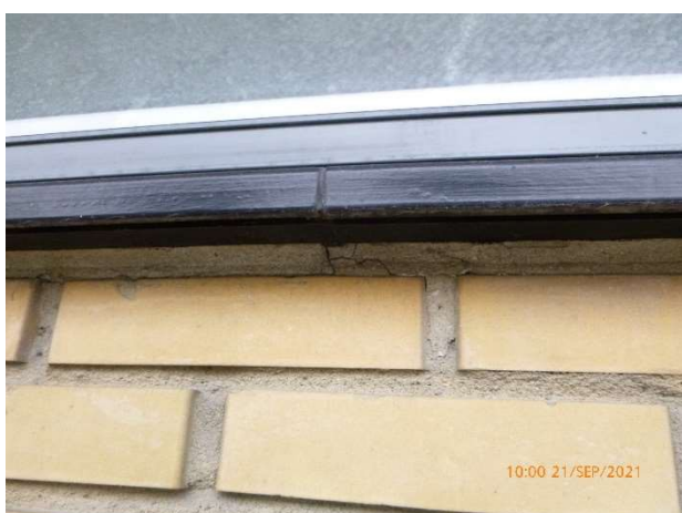
Foto 3. Der er generelt vandret revner under alle vinduers sølbænke. (Punkt 3)
