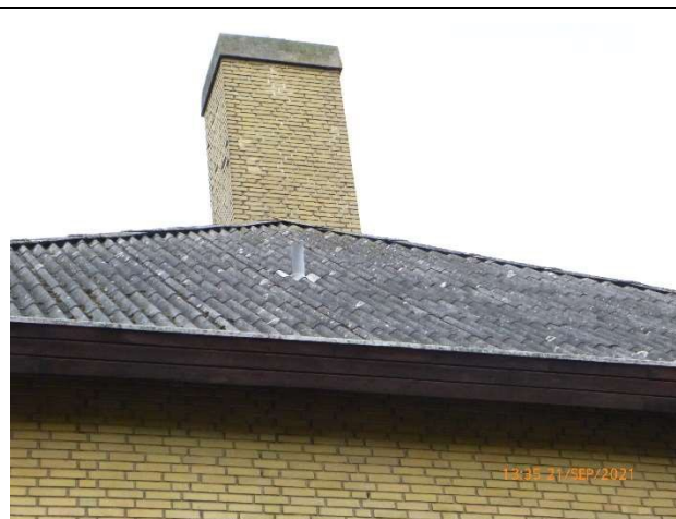
Foto 29. Der er afskalninger på skorstenen.(Punkt 29)
