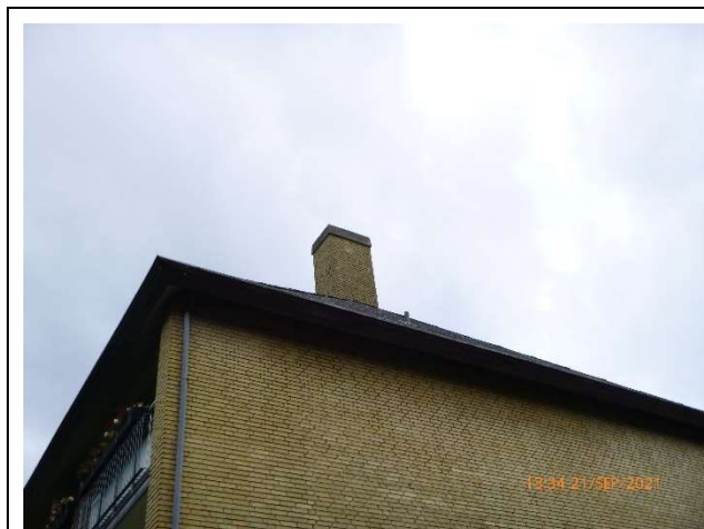
Foto 28. Der er afskalninger på skorstenen.(Punkt 29)
