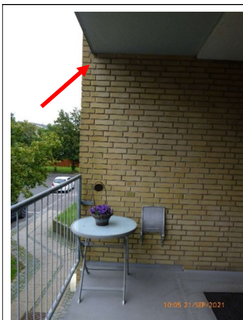
Foto 5. Murværket revner og afskaller omkring altangangselementerne. (Punkt 5)
