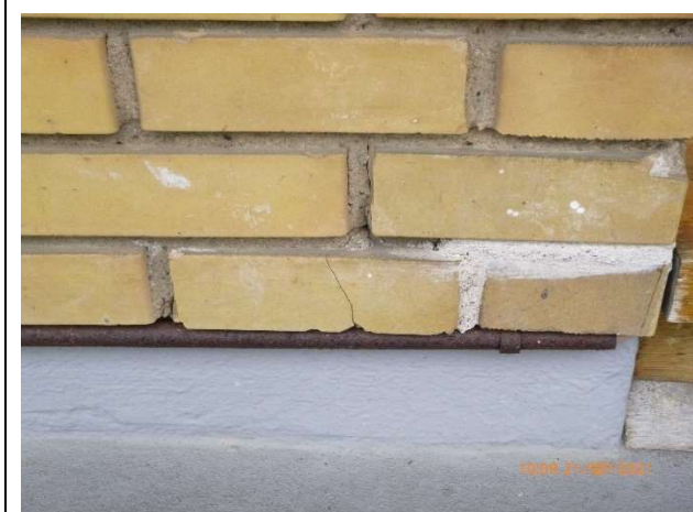
Foto 7. Lodret revne i mursten ved altangangselement. (Punkt 6)
