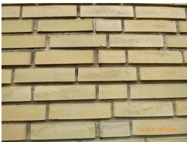
Foto 16. Der generelt mange studsfuger, som ikke er fyldte. (Punkt 14)
