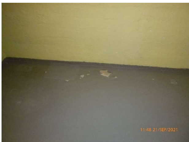
Foto 17. Maling afskaller på gulv i vaskerum. (Punkt 17)
