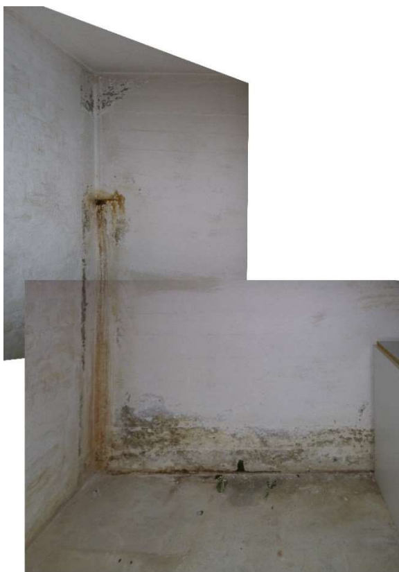
Foto 24. Fugt på ydervæg i lagerrum 63. (Punkt 23)
