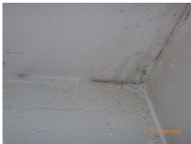
Foto 18. Der er en skade lige under loftet. Der er en afskalning eller knusning af toppen af væggen. Der kunne også være tegn på fugt. (Punkt 18)
