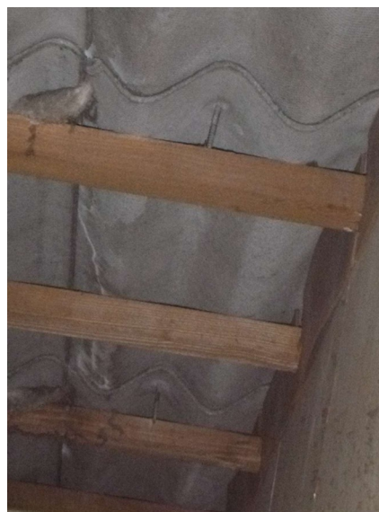
Foto 50. Der er et mindre antal tagplader, som er revnede.
