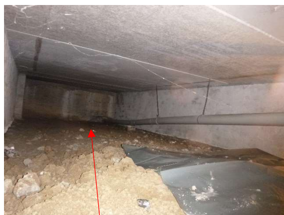
Foto 64. I området mellem 15 og 16 mangler der opstropning af kloakrøret. (Punkt 52)
