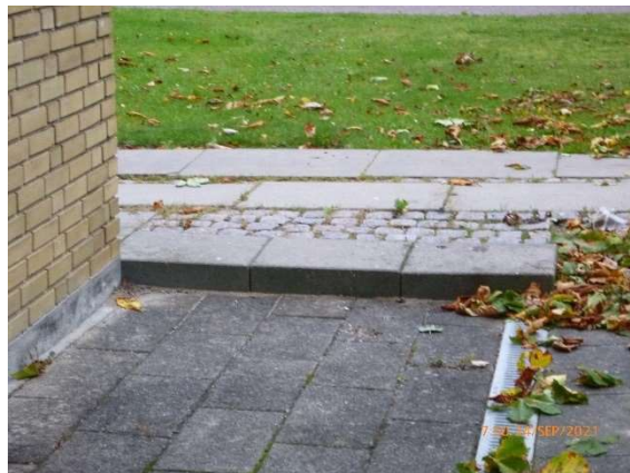
Foto 44. Terrænet hælder den forkerte vej, og der er et trin. (Punkt 26)
