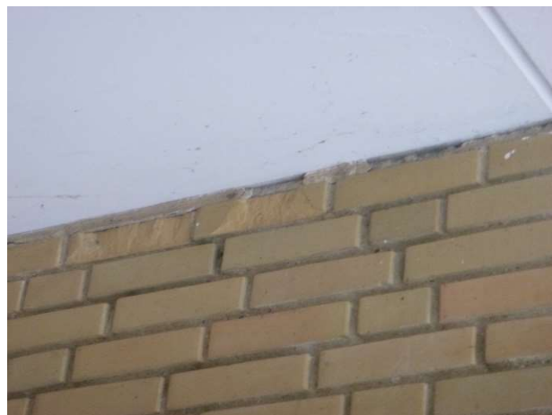
Foto 16. Mursten flækker langs undersiden af dækket. (Punkt 1)
