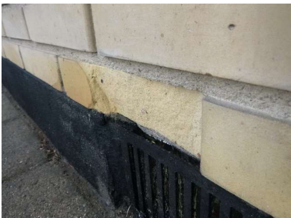
Foto 17. Afskalninger er mest kosmetiske og må kategoriseres som saltskader på grund af anvendelse af salt til glatførebekæmpelse. (Punkt 2)
