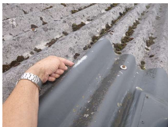
Foto 52. Inddækning om ovenlys skal tætnes.
