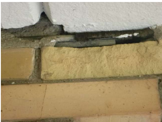
Foto 14. På 2. sal ses opløsningspladerne fra undersiden af altangangselementerne. Mørtelfuger og mursten er revet i stykker af betonens bevægelser. (Punkt 1)
