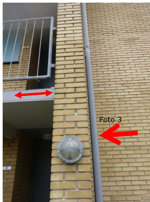
Foto 2. Altangangselementet trykker og trækker i endevæggen pga. temperaturbevægelser. (Punkt 1)
