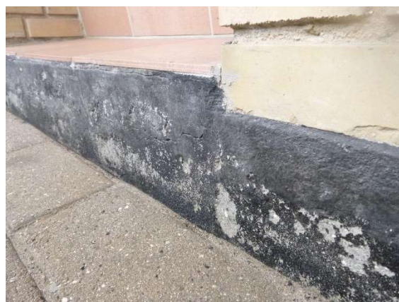
Foto 24. Maling på sokkel skaller af. (Punkt 9)
