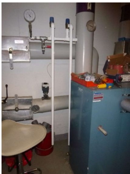
Foto 59. Overtryksventiler er ikke ført til gulv afløb. (Punkt 45)
