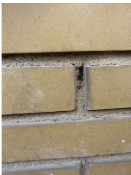
Foto 23. Der er en del studsfiger (de lodrette fuger mellem murstenene), som ikke er fyldte. Der er utæt for regnvand. (Punkt 8)
