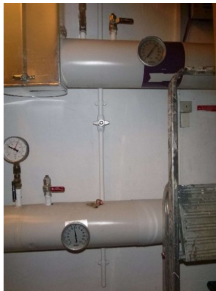
Foto 58. I fyrrummet ses, at der kun er 20 grader afkøling. (Punkt 44)
