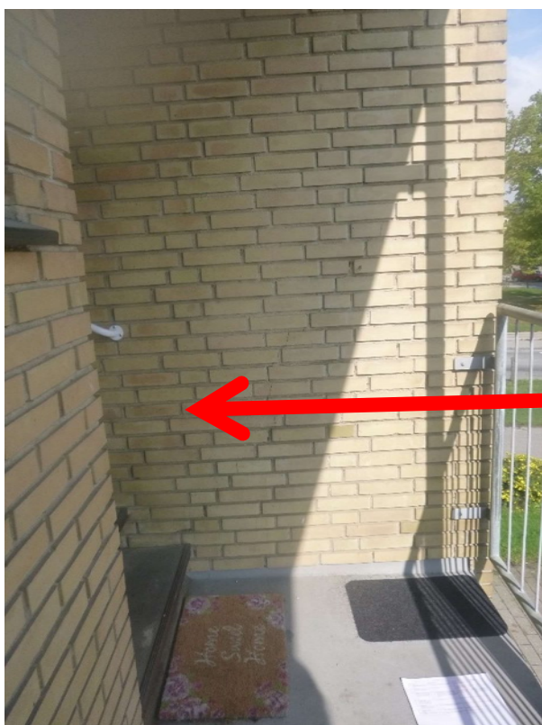
Foto 6. Murværk revner i endevæggen. (Punkt 1)
