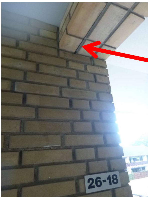
Foto 8. Murbjælke over altangang er trukket fra hinanden af bevægelserne. Se også foto 10. (Punkt 1)
