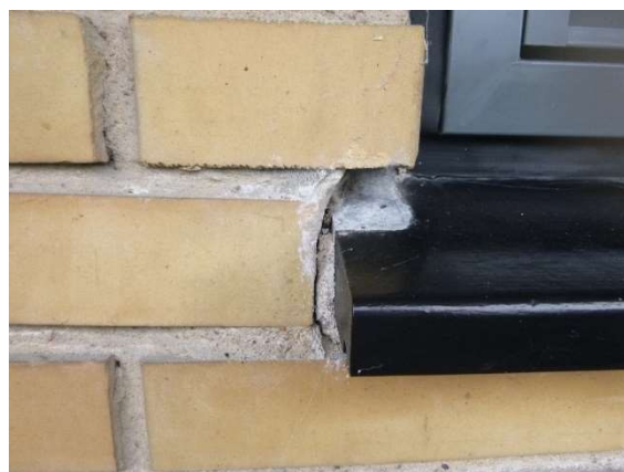
Foto 22. Ved enden af sålbænkene er mørtelfugerne knuste. (Punkt 7)
