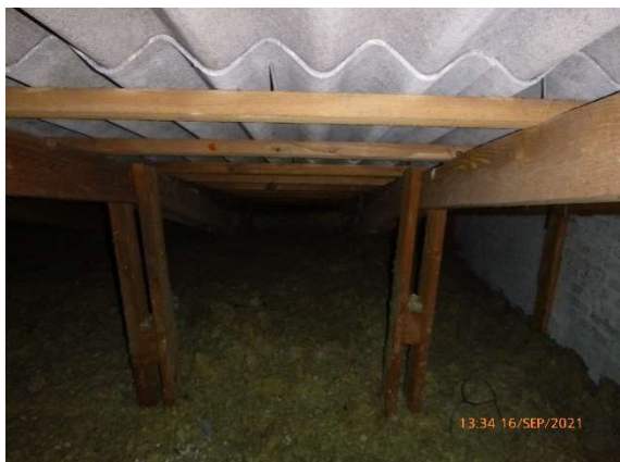
Foto 49. Der er et mindre antal tagplader, som er begyndende utætte.
