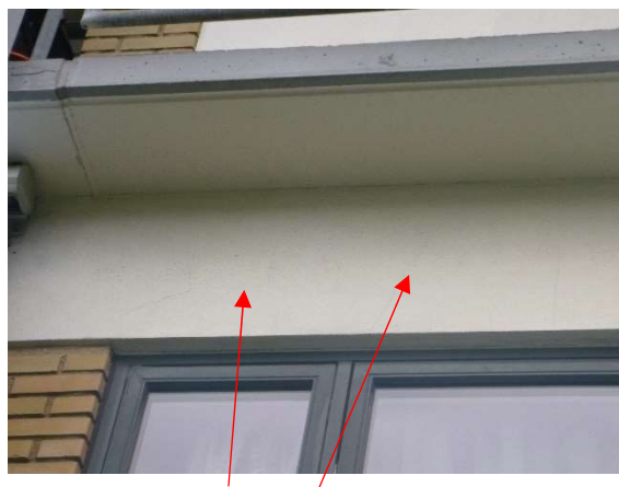
Foto 33. Der er lodrette revner i partierne over vinduerne.
