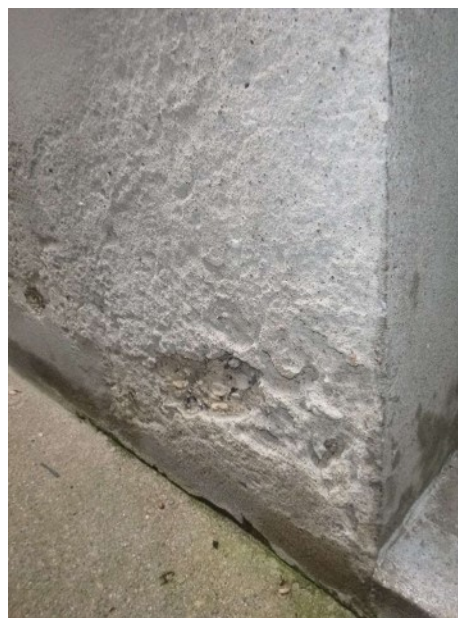
Foto 30. Sockelpudsen har saltskader ved kælderdoor.
