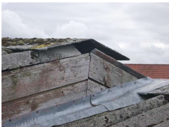
Foto 51. Der er en del rygningsplader, som er revnede ved bygningsspringet. Hul hvor fugle flyver ind. (Punkt 37)
