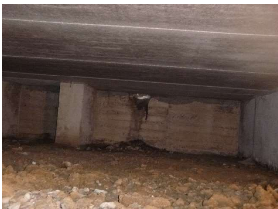
Foto 63. I området mellem 14 og 15 ses utætheder fra badeværelse i stueetagen. (Punkt 51).
