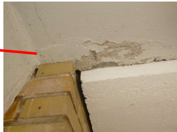
Foto 26. Der er fugtgennemtrængning på undersiden af altangangselement.(Punkt 10)
