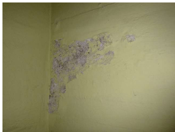
Foto 56. Der løber vand ind ad ventilationsristen. Der ses pletter på væggen. (Punkt 42)
