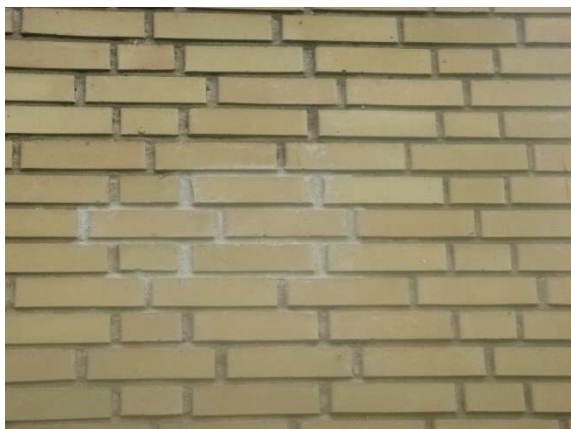
Foto 41. Hele gavlen: Der er mange studsfuger (de lodrette fuger mellem murstenene), som ikke er fyldte. (Punkt 24)
