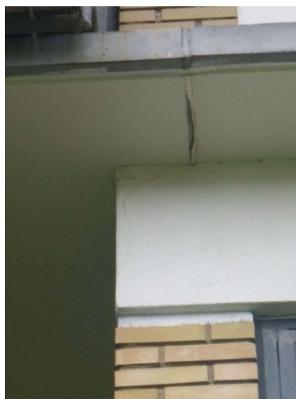
Foto 35. Vandret fuger er åben.
