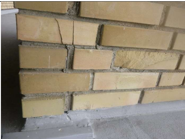
Foto 15. Mursten flækker ved altangangselementet. (Punkt 1)
