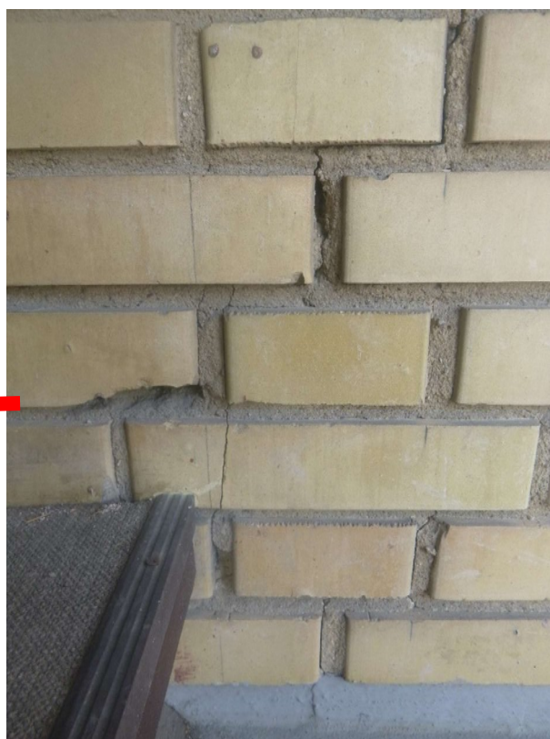
Foto 7 . Murværk revner i endevæggen. Detalje af Foto 6
