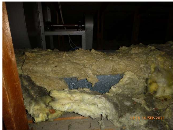
Foto 46. Isolering er trådt i stykker hvor der er passage hen over ventilationskanalerne.
