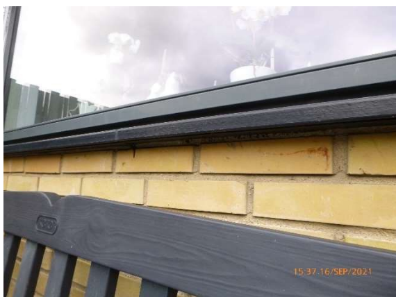
Foto 36. Der er generelt vandrette revner under alle vinduers sålbænke.
