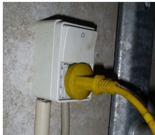
Foto 48. Stikkontakt ved adgangsstige mangler en dækplade.
