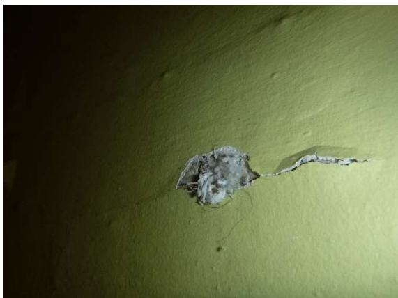
Foto 57. Der er generelt en ophobning af salte i ydervæggen mod altangangen. (Punkt 43)
