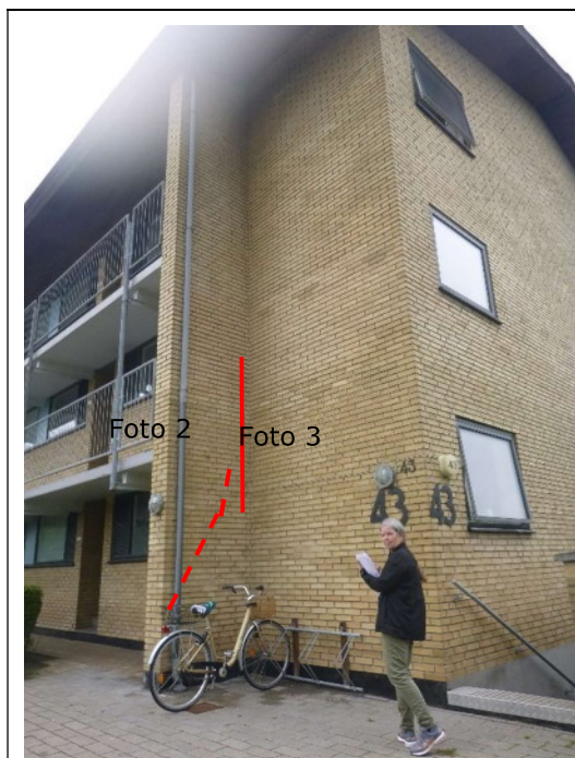
Foto 1. Endevæggen ved altangangen revner pga. temperaturbevægelser, som får altangangselementerne af beton til at skubbe til murværket. Stiplet streg angiver revner på modsatte side af væggen. (Punkt 1)
