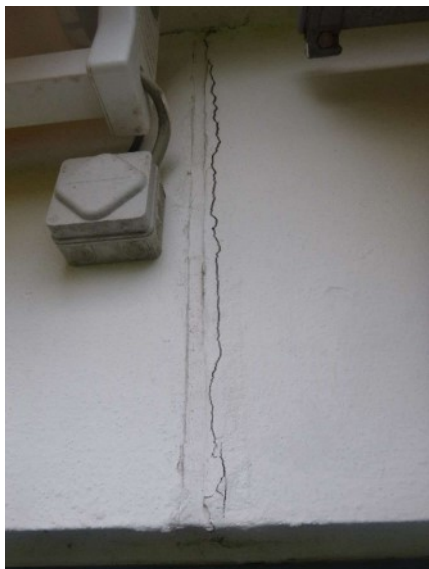
Foto 32. Der er generelt lodrette revner omkring fugerne mellem alle altan-elementerne. Nogle steder er det dækkende betonlag på armeringen revnet fra.
