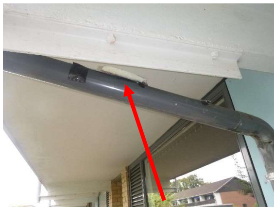
Foto 20. Revne i overside af nedløbsrør. (Punkt 5)
