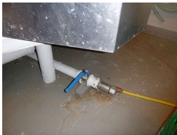
Foto 60. Afløb fra beholdertømning er ikke ført til gulv afløb. (Punkt 46)
