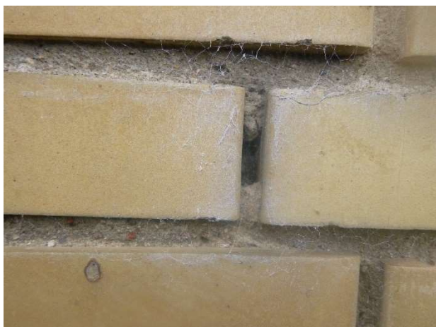
Foto 29. Hele gavlen: Der er mange studsfuger (de lodrette fuger mellem murstenene), som ikke er fyldte.
