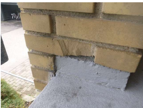
Foto 12. Knækket mursten ved altangangselementet 1. sal nær trappeopgangen er afrevet af betonens temperatur bevægelser. (Punkt 1)
