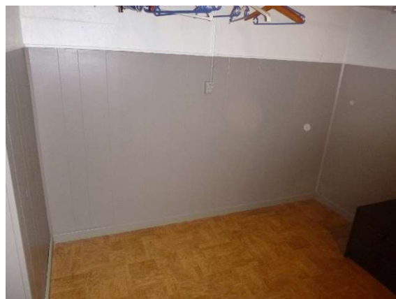
Foto 62. I fællesrummet er der træpaneler på væggene. (Punkt 48)
