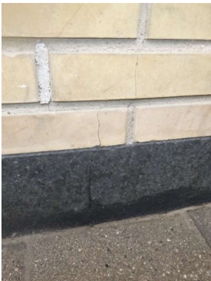
Foto 19. Lodret revne tæt på terræn. Er uden betydning. (Punkt 4)
