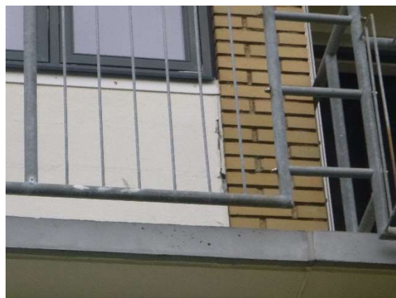
Foto 37. Muren under vinduet er revnet.
