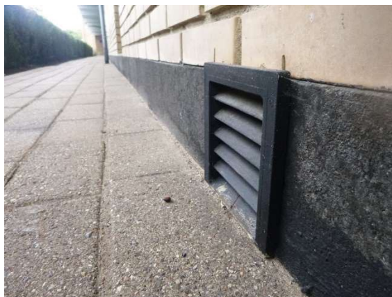
Foto 18. Riste til udluftning af kælder er meget tæt på terræn. Ved skybrud eller i snevejr kan der trænge vand ind i kælderen. (Punkt 3)
