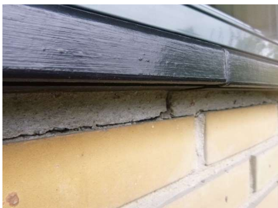
Foto 21. Der er generelt vandret revner under alle vinduers sålbænke. Temperaturbevægelser og manglende mulighed for at udvide sig, så sålbænkene løfter. (Punkt 0)
