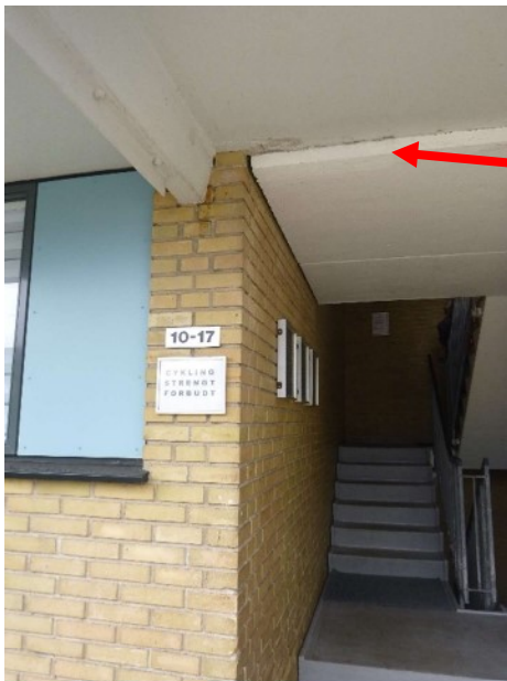
Foto 25. Der er fugtgennemtrængning på undersiden af altangangselement.(Punkt 10)
