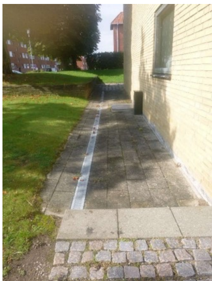
Foto 43. Terrænet hælder den forkerte vej, og der er et trin. (Punkt 26)
