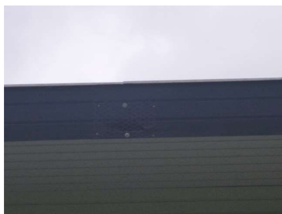
Foto 39. Udhænget er fugtskadet og partielt rådden. Tidligere reparationer med metalnet for at holde fugle ude fra loftet. (Punkt 22)
