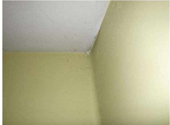
Foto 54. Fugtplet ved loftet på gavlvæg i (Punkt 40)
