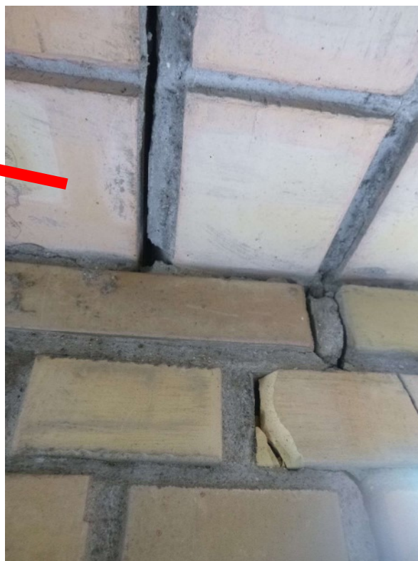
Foto 9. Der ses åbne revner mellem murstikkene og revner ned gennem murværket nedenunder dem. (Punkt 1)
