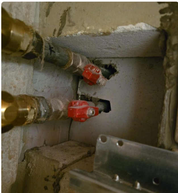
Vandrør med ventiler og korrosion
