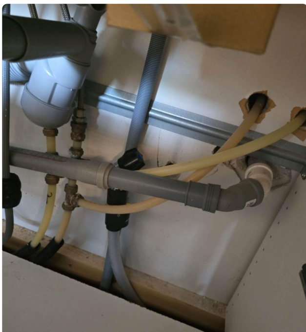
Vandrør og ventiler med isolering
