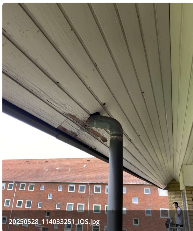
Vestergårdsvej 23: Afskallende maling og nedbrudt træværk omkring tagnedløb, som kan tyde på utæthed.
