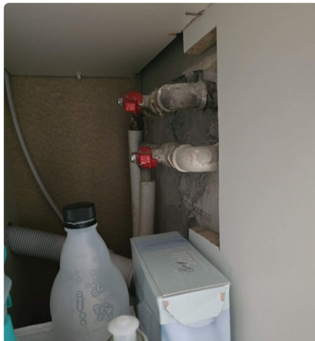
Vandrør med korrosion og manglende isolering
